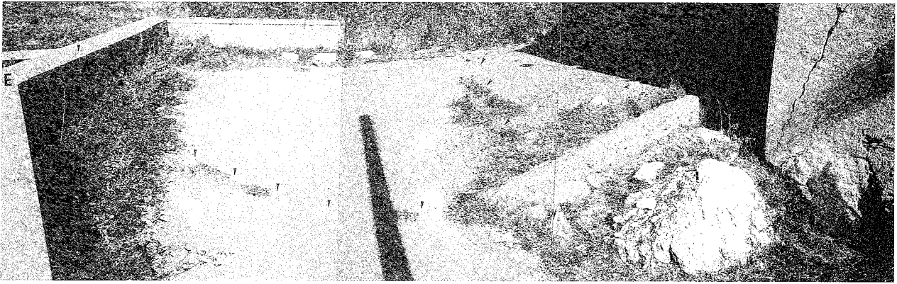
Fig. 9f - Zona di Cascia. Fratture nei manufatti, in località Chiavano, generatesi durante il terremoto di Norcia del 1979. La direzione delle fratture (evidenziata dalle frecce) rispecchia la direzione delle principali faglie della zona: nord-sud e NW-SE. La frattura orientata NW-SE (in primo piano) che si continua a destra nella foto, nel bedrock , al di sotto del manufatto, si può seguire, a sinistra, oltre il parapetto, lungo il muro e nel bedrock (vedi Fig. 9g).
