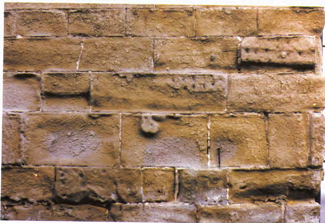
Fig. 4 - Il muro esterno del Palazzo Ducale è formato da grossi blocchi di arenaria, che appare interessata da gravi processi di alterazione. Infatti, la superficie attualmente esposta agli agenti atmosferici risulta talvolta di parecchi cm al di sotto della superficie originaria, caratterizzata dalla presenza del "bugnato". Il grado di alterazione è piuttosto variabile da blocco a blocco in funzione del grado di originaria litificazione e dalla presenza di livelli più carbonatici.
