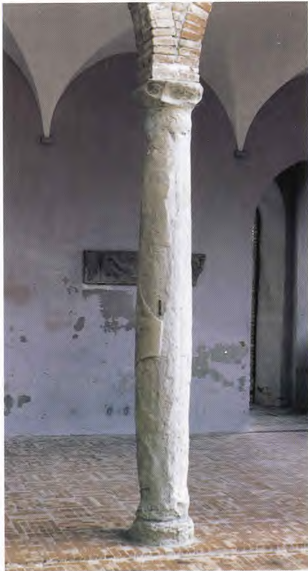
Fig. 2 - Colonna interessata dai processi di degradazione; sono ben visibili gli effetti dell'alterazione che hanno determinato oltre alla scomparsa degli elementi decorativi anche una considerevole “desquamazione” con riduzione dello spessore stesso della colonna. Da notare come la parte basale risenta dell'azione, sia chimica che meccanica, dell'acqua meteorica. L'azione meccanica della pioggia diretta e degli schizzi provenienti dal pavimento, provoca il distacco dei granuli, determinando un aumento della microporosità e conseguentemente un aumento complessivo dell'umidità delle parti basali
