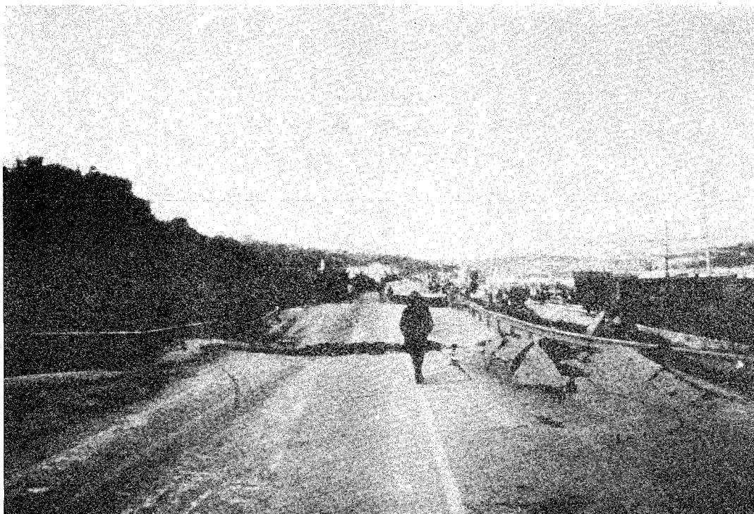
Fig. 4.12 - Rigonfiamenti del suolo in corrispondenza del piede della frana Barducci. Ground bulging at the foot of the Barducci landslide.
